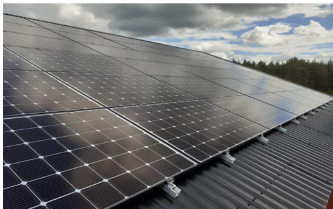
Ovan syns en nätansluten installation gjord av Implementa på 20,8 kWp som driftsattes sommaren 2020 på ett maskinhall i Sjöbo.
